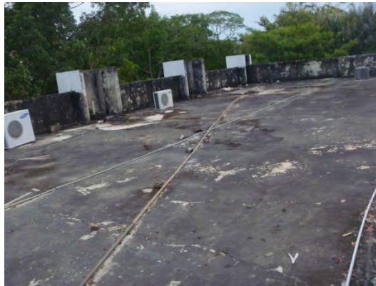
Fig. 1.2.- Fotografía del techo de las oficinas de la SAGARPA, el cual no cuenta con aislante térmico.
