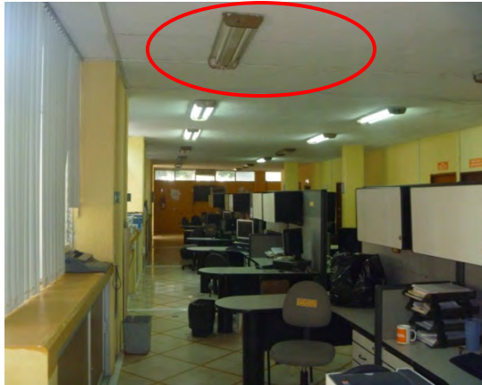
Fig. 1.6.- Fotografía en la que se aprecia un par de lámparas que no funcionan.
