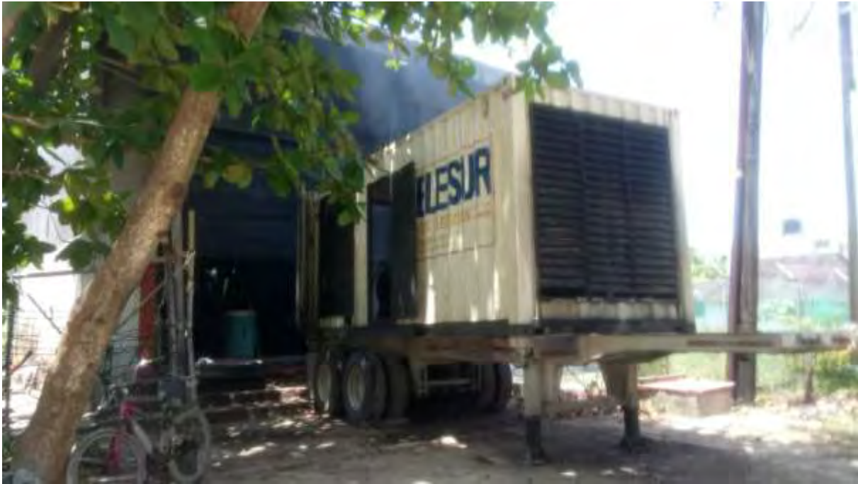
Figura 10 Planta de combustible abastecedora de luz a la comunidad Punta Allen
