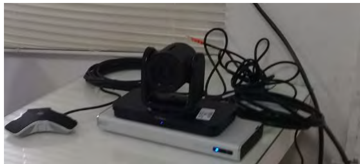
Ilustración 26 Instalación de Equipo para Teleeducación en Kantunilkín; foto realizada por Diego Acosta
