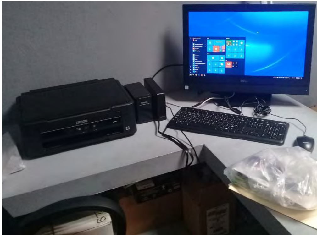
Ilustración 25 Instalación de Equipos para Telemedicina en JMM; foto realizada por Diego Acosta
