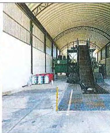
Imagen 2. Infraestructura en estado de abandono que se encuentra al interior del Sitio.
