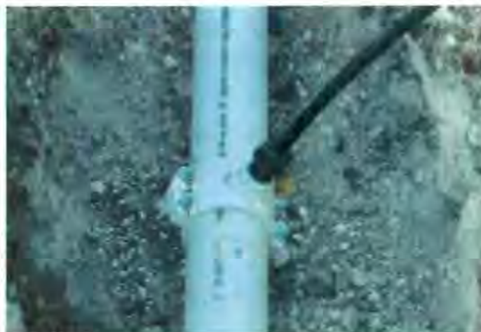
Fotografía No. 10 Vista de toma domiciliaria con adaptador de compresión.
