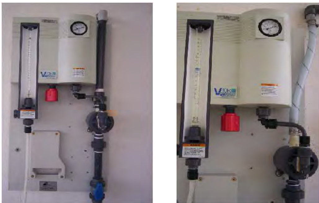
Fig. 14.- Dosificadores de cloro gas, Ucum 1 y Ucum 2. (Comisión de Agua Potable y Alcantarillado, Chetumal Q. Roo, septiembre de 2007)
