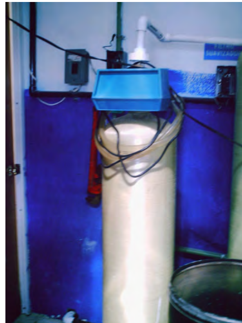
Fig. 17. Filtro con Carbón activado.
