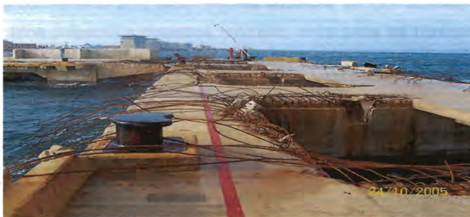
Foto 3: Muelle en Cozumel destruido por el Huracán Wilma.
