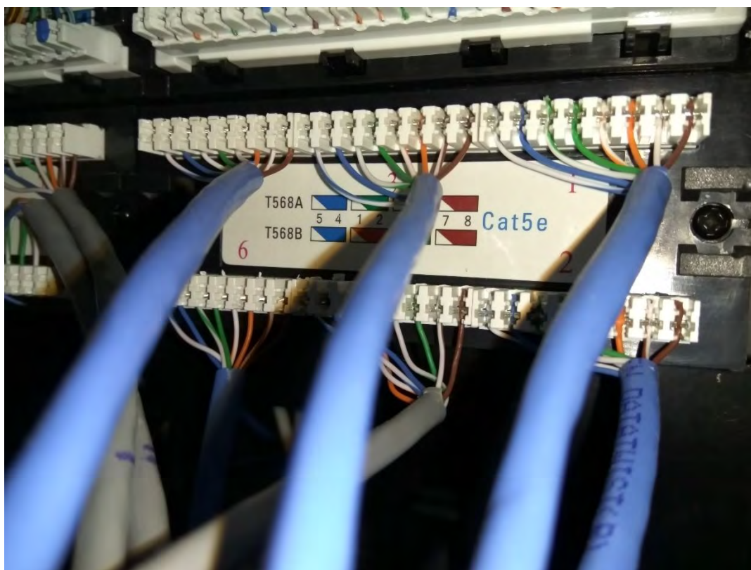
Figura 22 Conexiones en Patch Panel Fuente: Elaboración Propia
