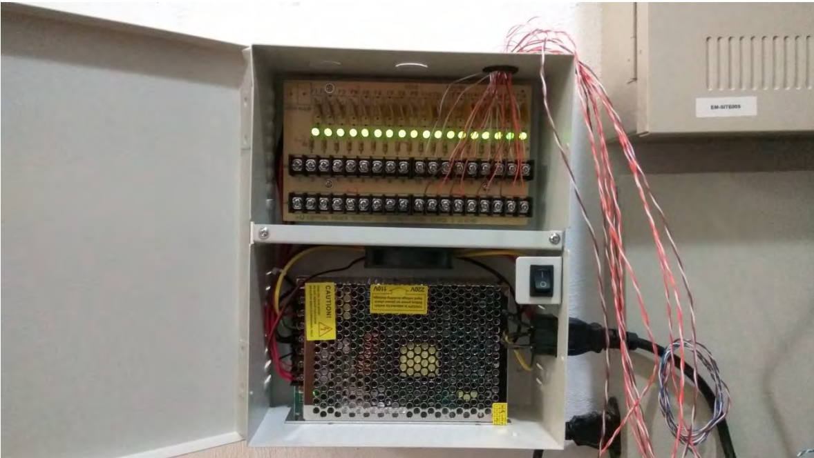
Figura 13 Fuente de alimentación de cámaras 12VDC-18 Fuente: Elaboración Propia
