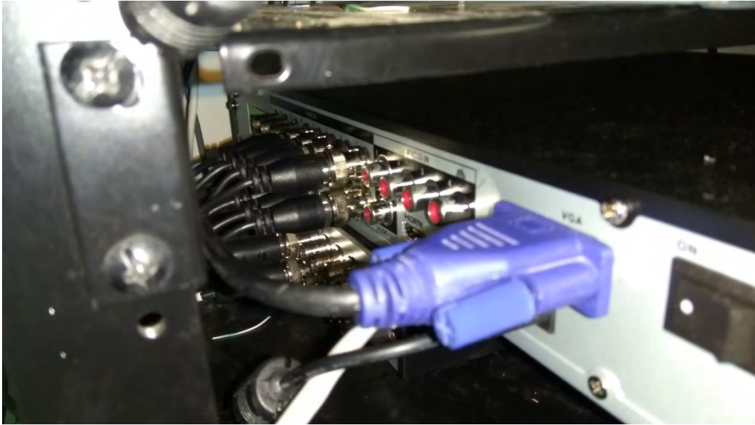
Figura 14 Conexión posterior del DVR Fuente: Elaboración Propia
