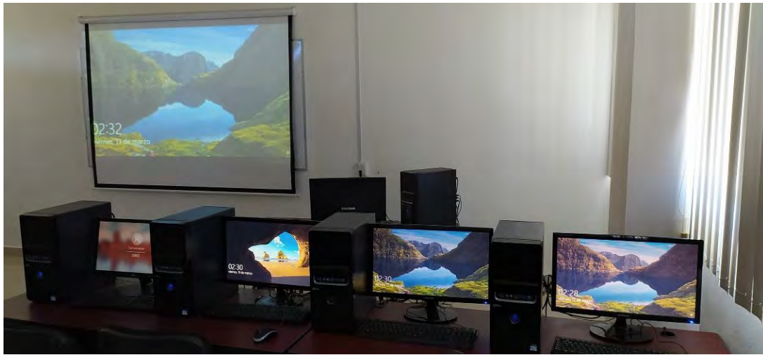
Figura 5 Supervisión de equipamiento instalado en Centro de Cómputo Fuente: Elaboración Propia
