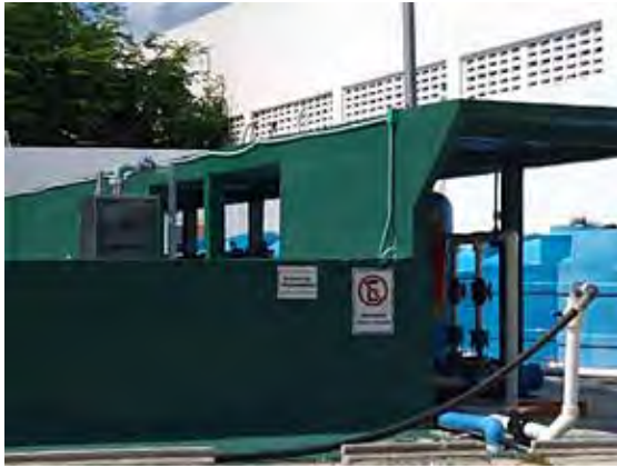
Figura 7. Aprovechamiento eficiente el agua. Planta de Tratamiento de aguas residuales en hoteles de la Riviera Maya. Fuente: elaboración propia.
