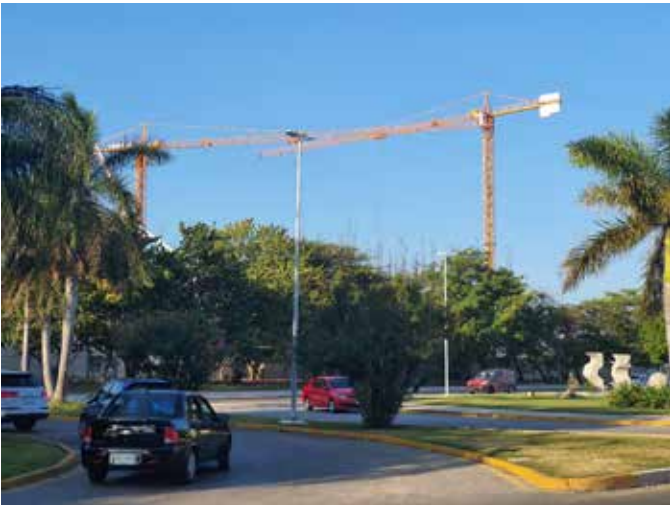
Figura 4. Grúas de construcción vistas desde el Boulevard Kukulcán, avenida que recorre la zona hotelera. A pesar de la densidad hotelera en la zona, existen algunos proyectos en plena construcción. Fuente: Elaboración propia.
