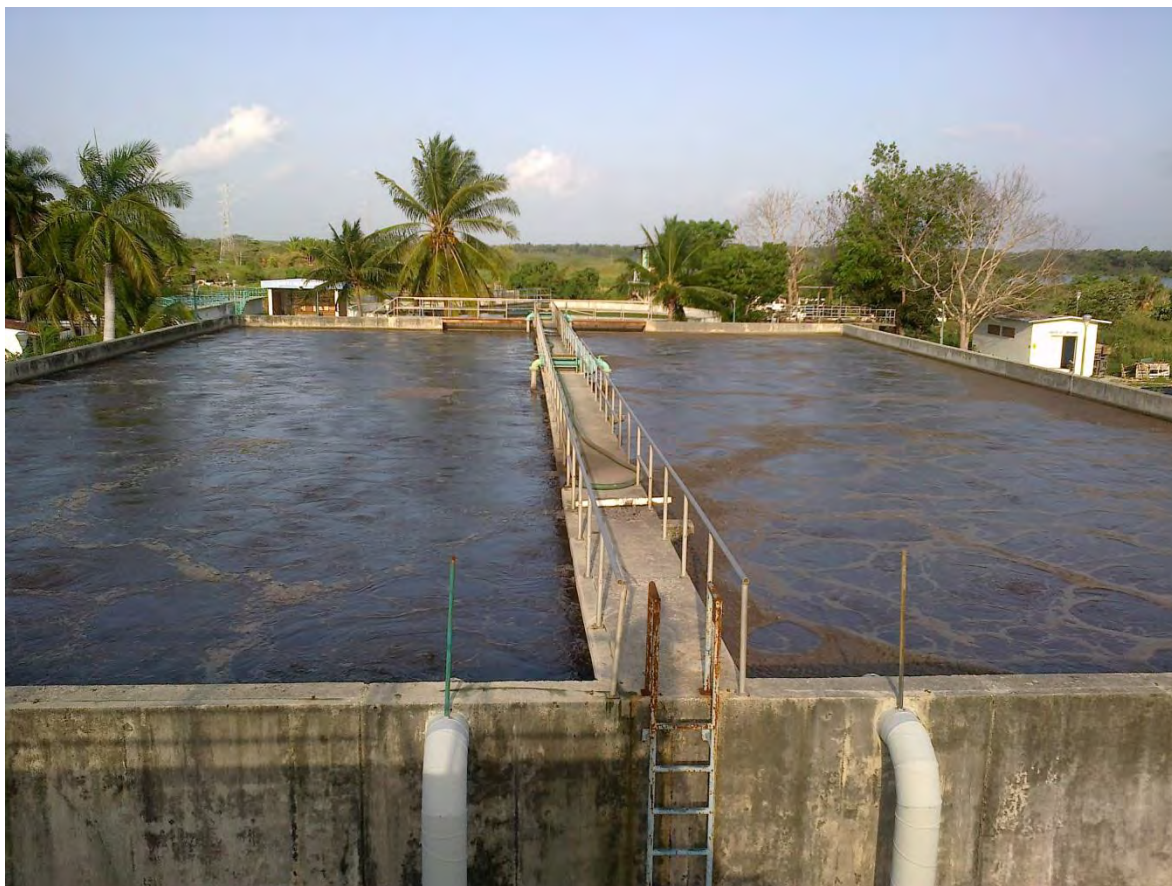
Fig. 1.3.- Reactor Biológico de la Planta de Tratamiento Centenario.
