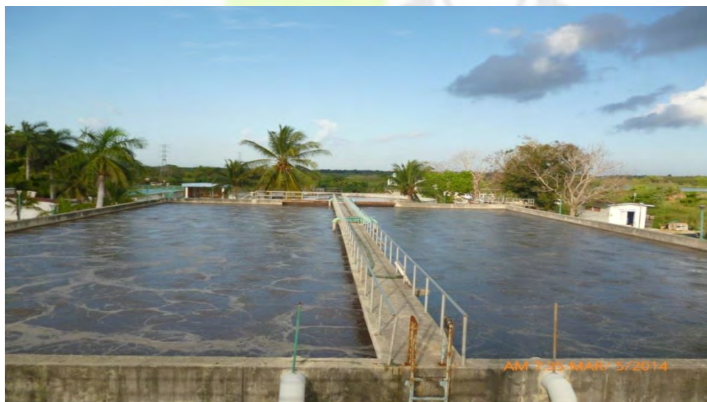
Fig. 3.15.- Reactor Biológico de la Planta de Tratamiento de Aguas Residuales Centenario.
