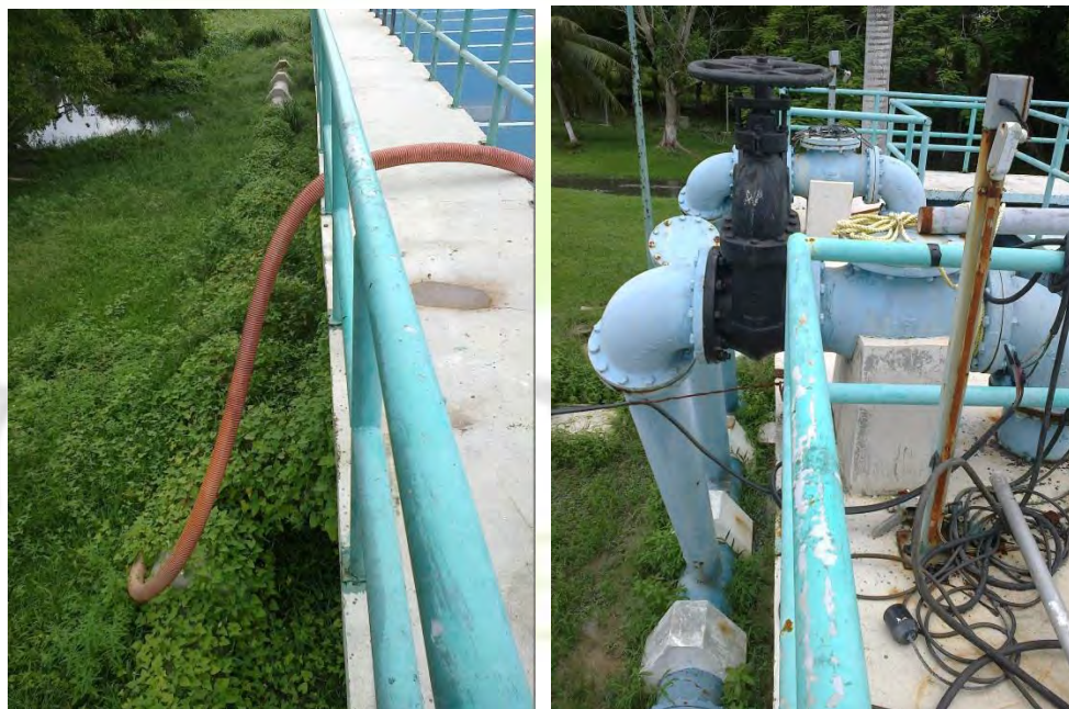
Fig. 3.12 y 3.13.- Tubería hacia pozos de absorción y válvulas y bombas para alimentar los pozos de absorción con el agua tratada, respectivamente.
