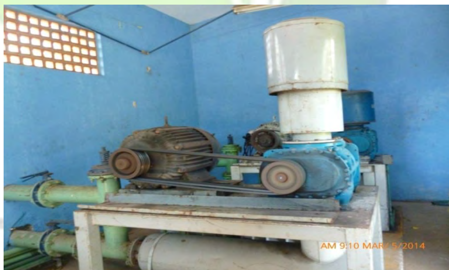
Fig. 3.19.- Sopladores de Desplazamiento Positivo.
