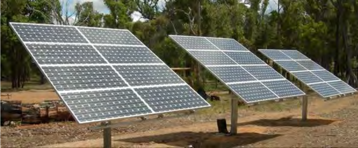
Figura 4. Fotografía de módulos fotovoltaicos (IPS solar, 2012).
