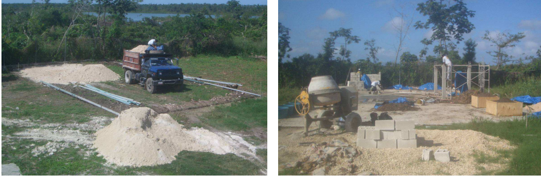
Figuras 2.4 y 2.5 Preparación del sitio e inicio de las obras de construcción
