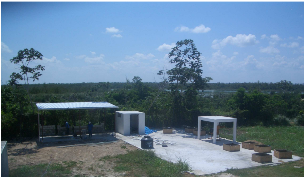
Figura 3.1 Instalaciones concluidas de la Planta piloto de composta “Primer Centenario”
