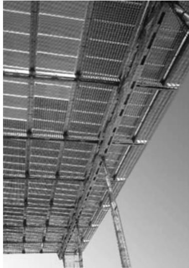
FIGURA 1. PARTE DE UNA TECHUMBRE FOTOVOLTAICA DE 10 MIL METROS CUADROS EN HERNE, ALEMANIA
