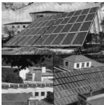
FIGURA 2. DIVERSAS INSTALACIONES DE CALENTADORES SOLARES DE AGUA PARA USO RESIDENCIAL Y DE SERVICIOS
