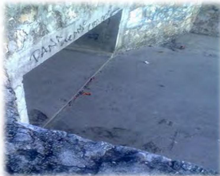
Figura 3.2.- Descarga ubicada a un costado del Hotel Hacienda Bahía (punto A).
