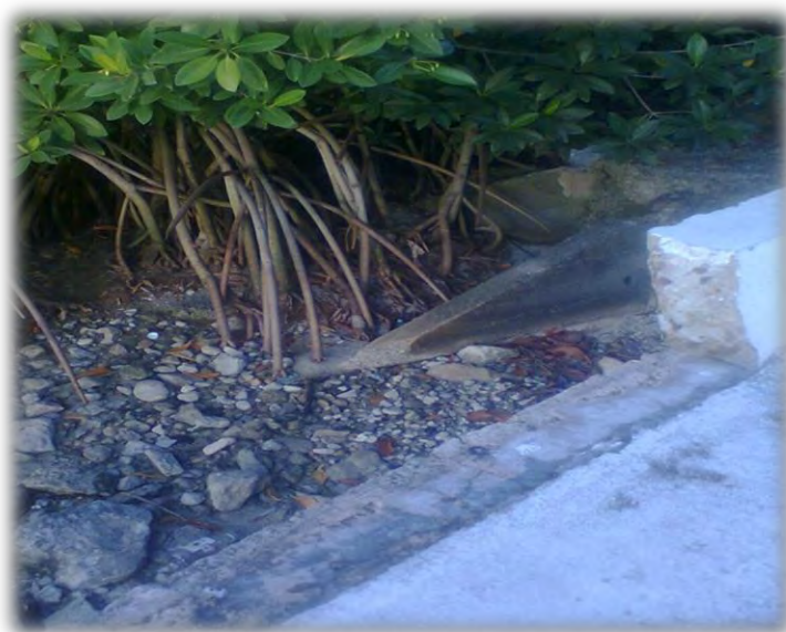
Figura 3.5.- Descarga ubicada enfrente de restaurant Drinks (punto D).
