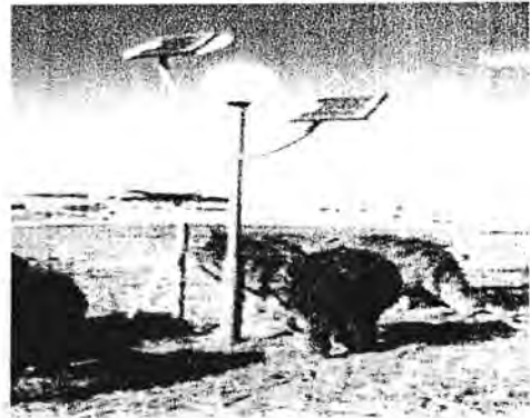
Figura I.8b-Sistema fotovoltaico en alumbrado exterior.
