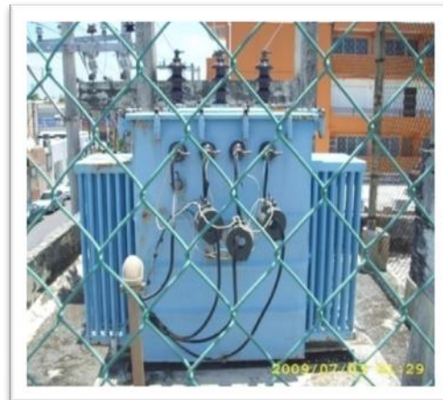
Figura 9.- Fotografía: Transformador sin placa de datos visible.
