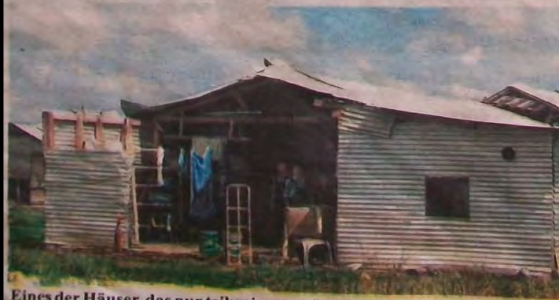
Eines der Häuser, das nur teilweise zerstört wurde.
