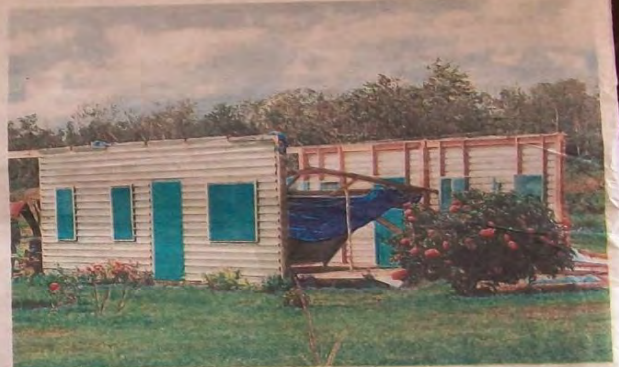
Vor dem Sturm sah dieser Hof gepflegt aus, jetzt sehen nur noch die Pflanzen schön aus. Das Haus wurde zerstört.
