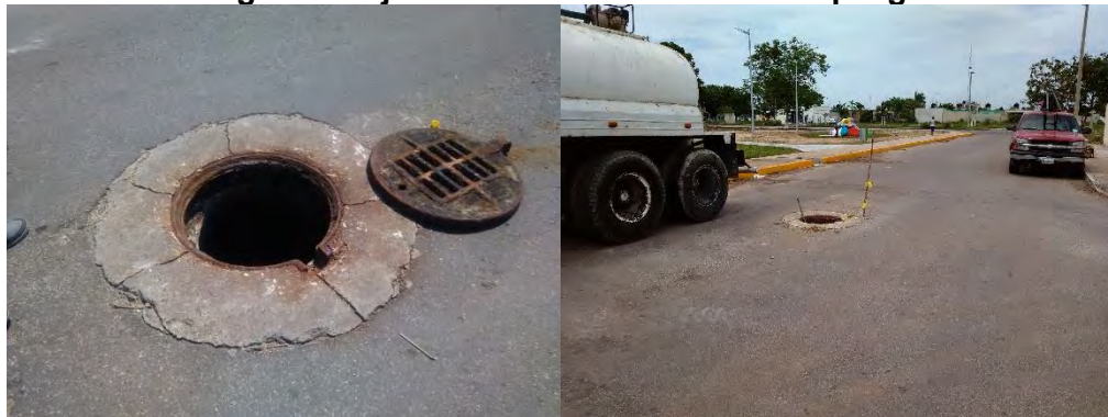
Imagen No. 30 La fotografía de la izquierda fue tomada en septiembre de 2017. En junio de 2018 seguía igual. Solo le habían puesto algunos objetos como señalamiento del peligro.
