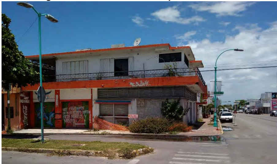
Imagen No. 22 Edificio afectado por el hundimiento.
