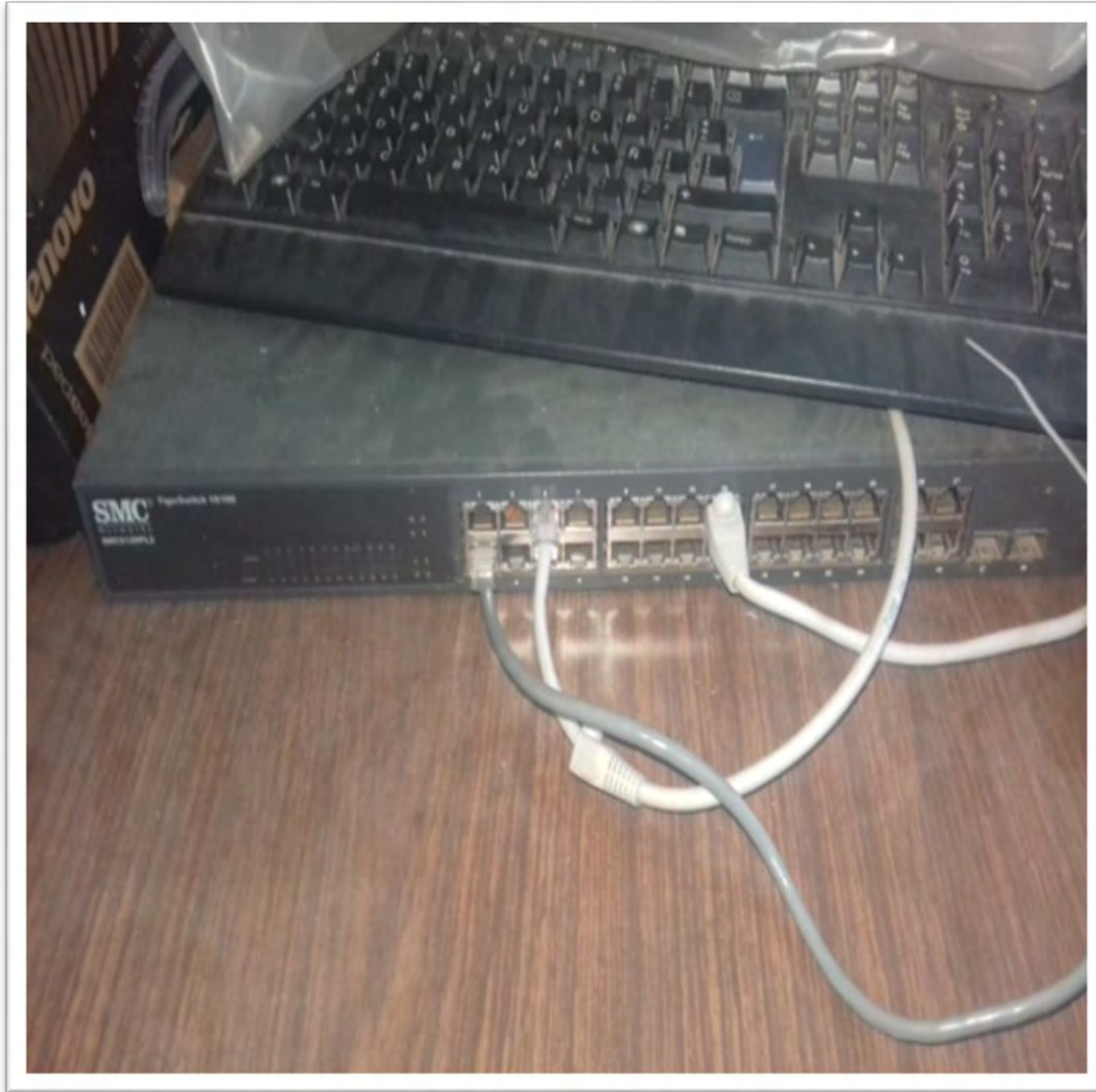
Figura 3 Equipo de telecomunicaciones (Sin utilizar)
