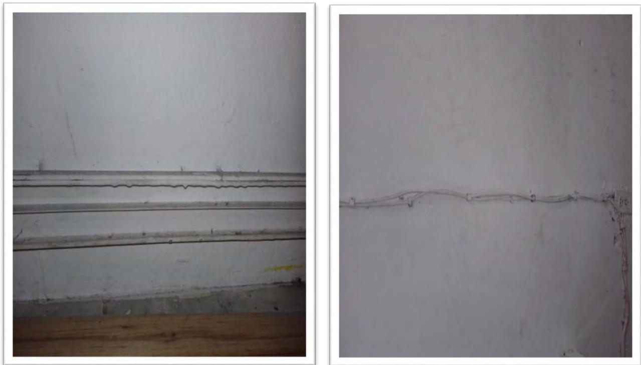
Figura 4 Condiciones generales del cableado
