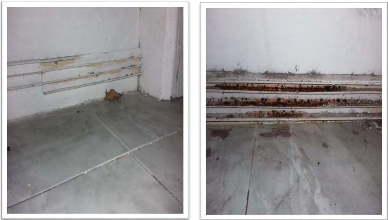
Figura 5 Canaletas en condiciones desfavorables
