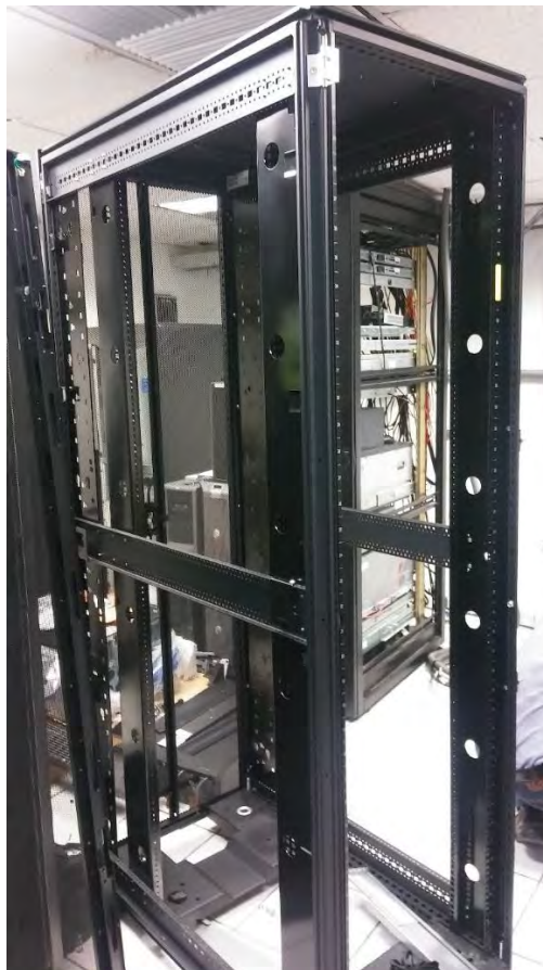
Figura 4-14. Rack de gabinete cerrado
