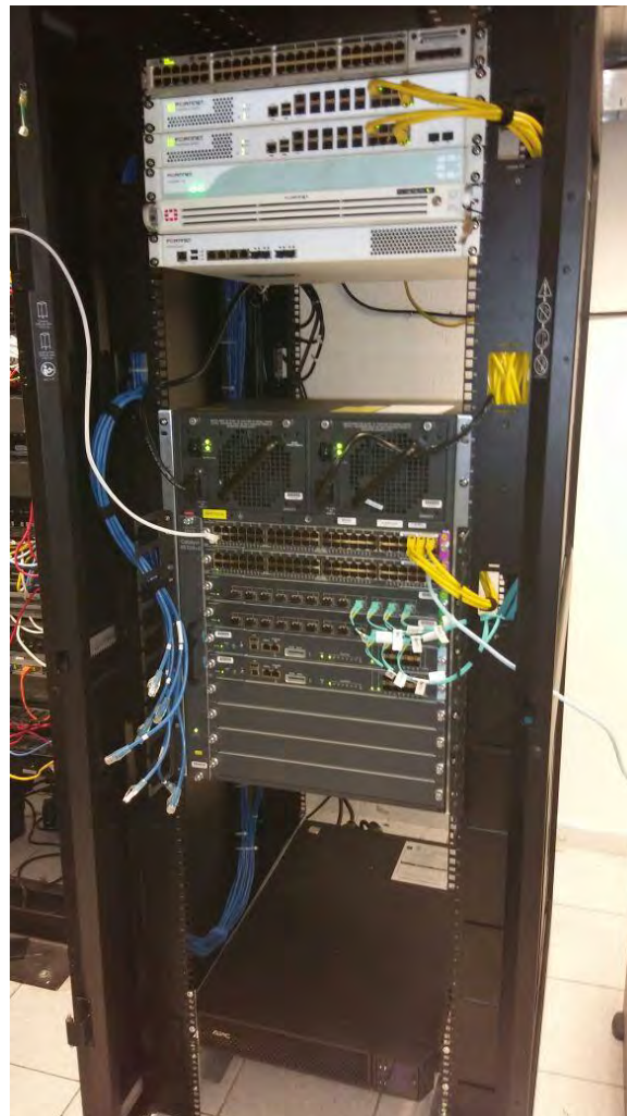
Figura 4-21. Clúster FortiGate y switch Cisco Core en rack
