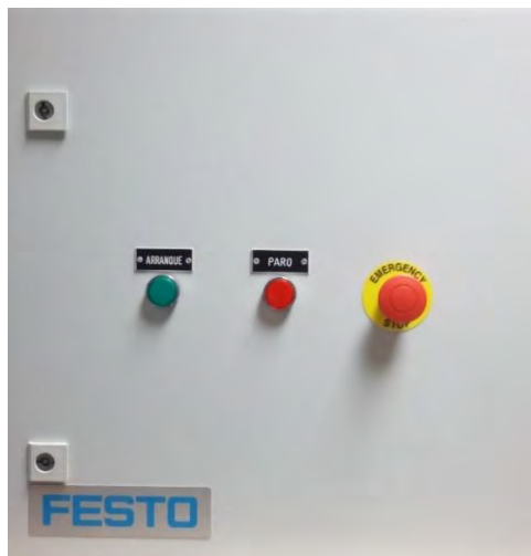
Figura 3.18. Botones de arranque, paro y paro de emergencia instalados en el gabinete de control.
