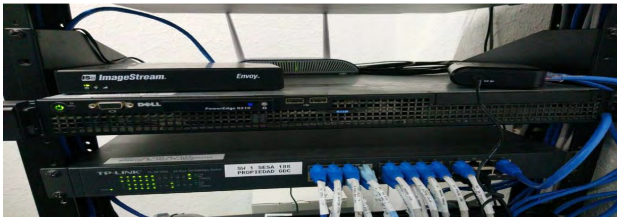
Figura 7. Patchpanel con cables y switch debidamente etiquetado
