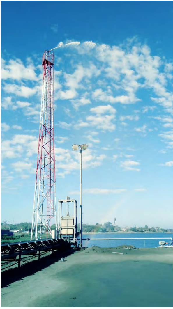
Imagen 3. Aspersor instalado en el muelle de desembarque.
