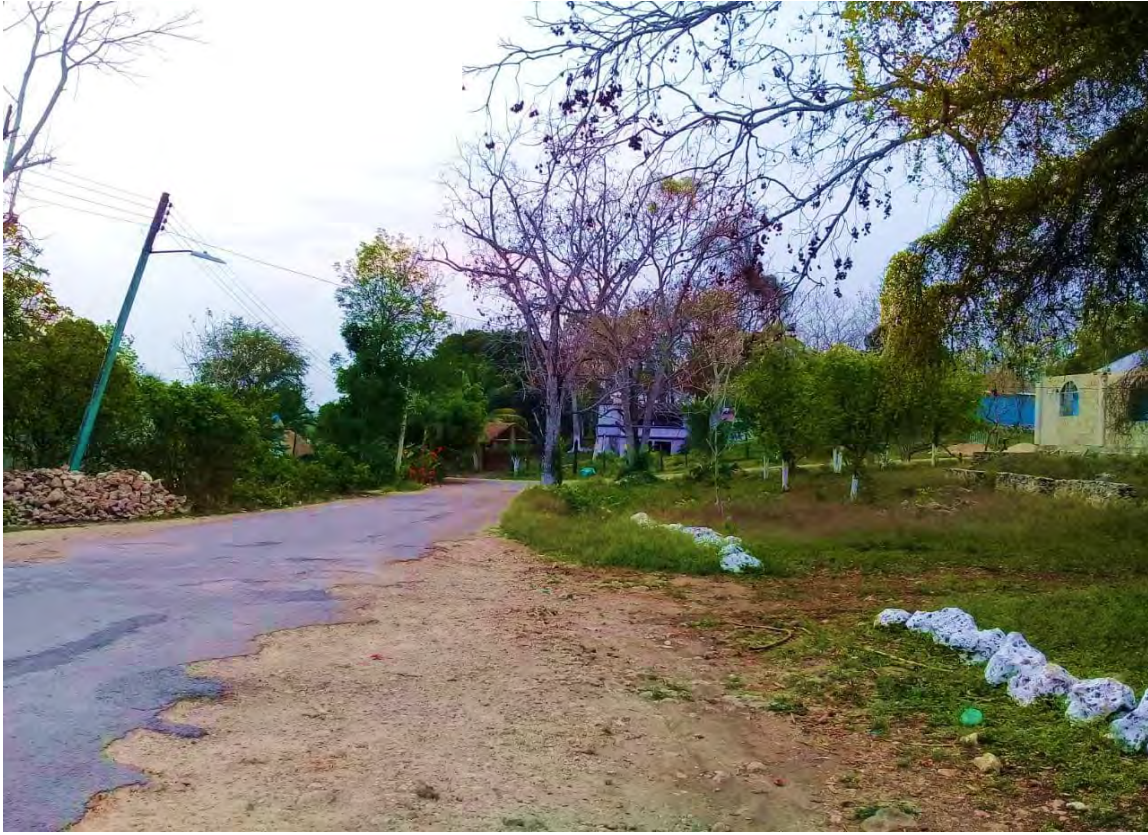
ENTRADA DE LA COMUNIDAD DE SFB, CALLES DETERIORADAS
