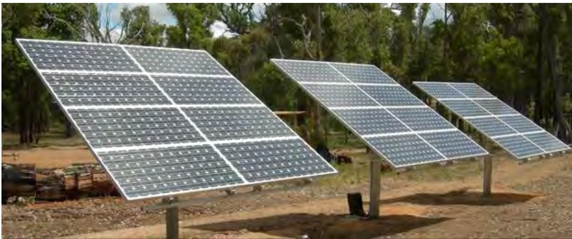
Figura 34: Fotografía de estructuras de soporte en suelo (IPS solar, 2012).
