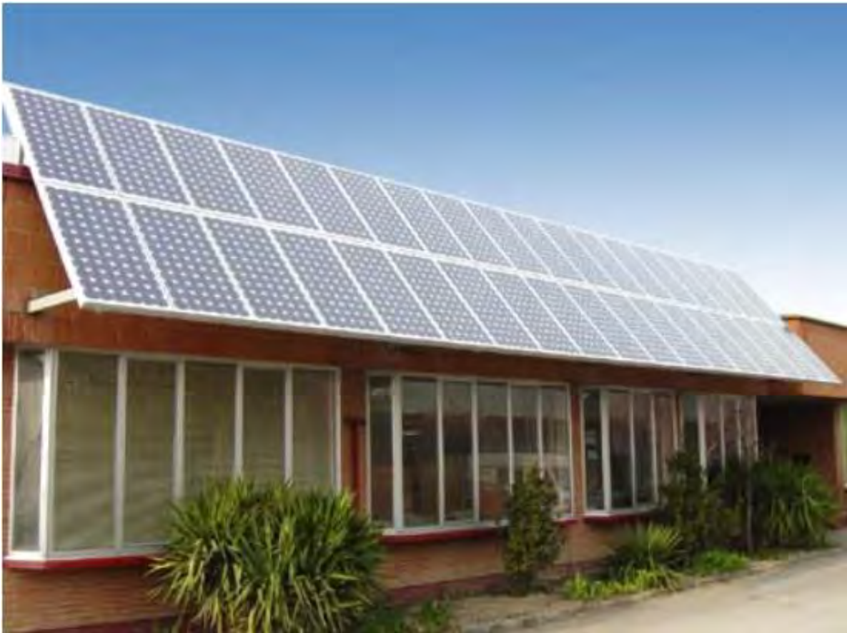
Figura 36: Fotografía de módulos solares en pared (Bricolaje, 2011).
