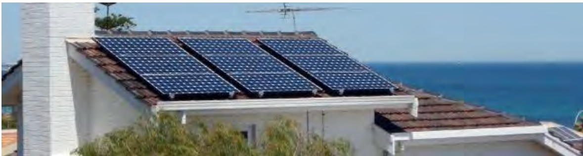
Figura 37: Fotografía de estructura de soporte en techo (IPS solar, 2012).
