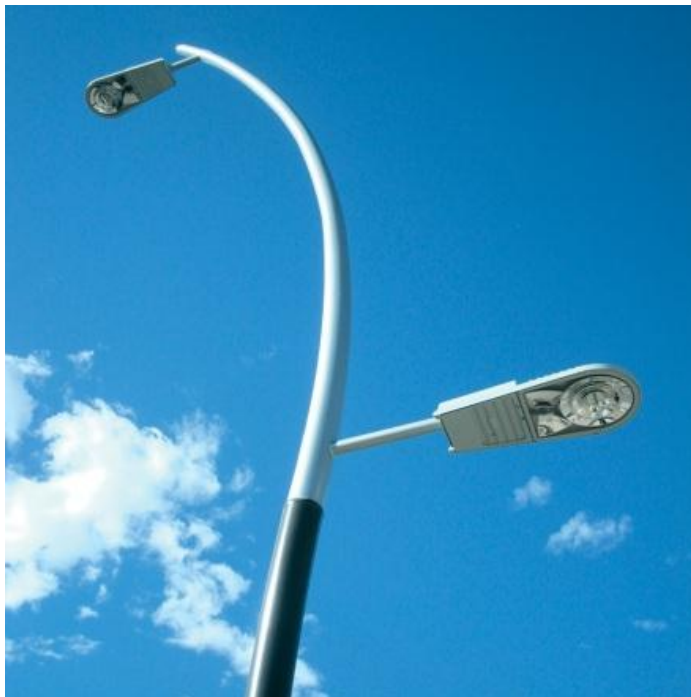
Figura 2.10.- Ejemplo de tipo de lámparas instaladas en el municipio de Othón P. Blanco.
