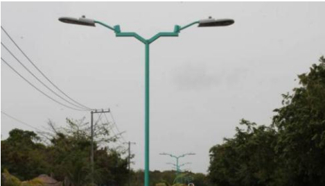
Figura 2.8.- lámpara leds instalado en avenida
