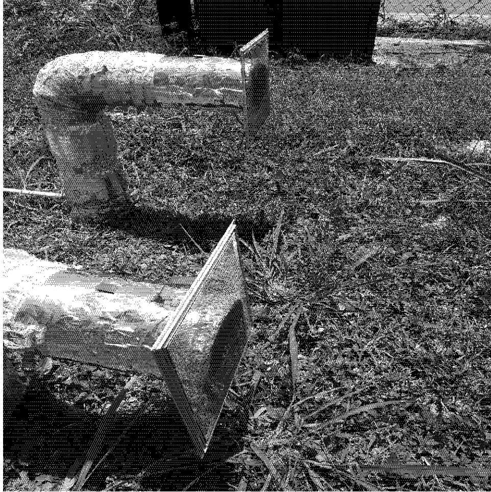
Figura 1.6: Protección en la entrada del ICG
