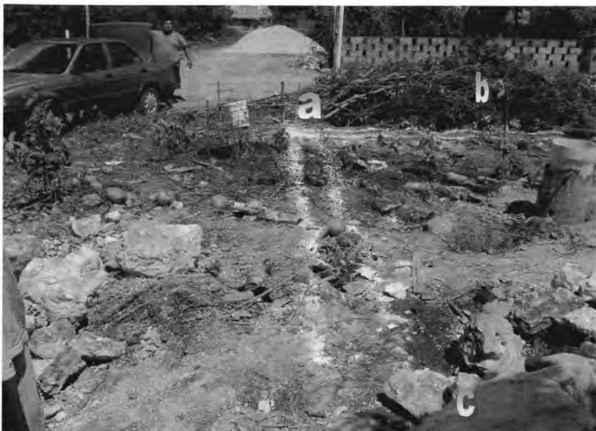
Figura 1. Trazo en terreno, a) Delineado con cal con apoyo de estacas e hilo; b) Retiro de arbustos y c) Retiro de material suelto a mano.
