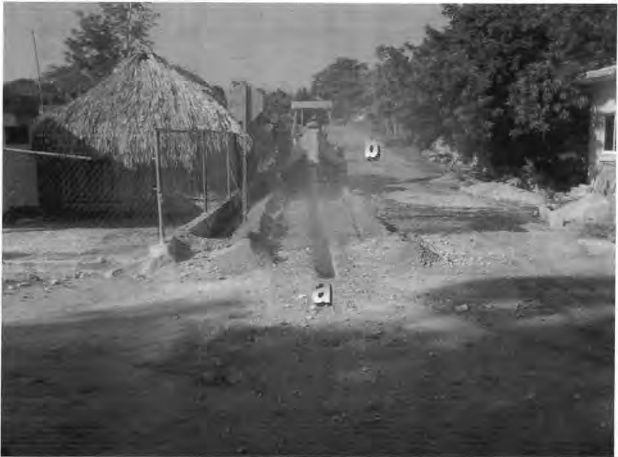
Figura 3. Excavación de zanjas; a) Excavación de zanja en material tipo III por medios mecánicos; b) maquinaria en operación (cortadora tipo disco).
