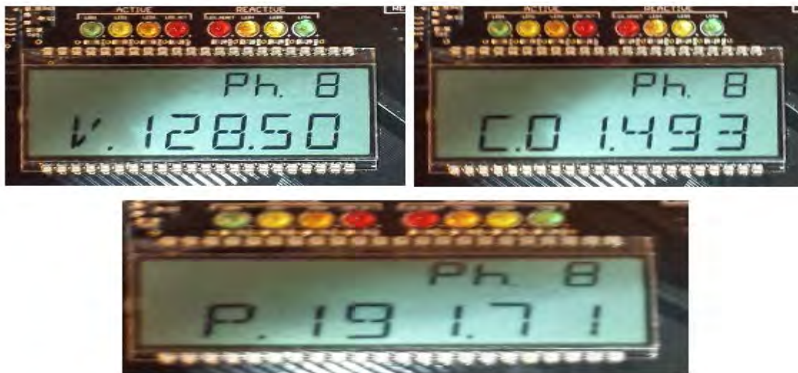
Figura 4. 14 Valores de voltaje, corriente y potencia en la fase B.
