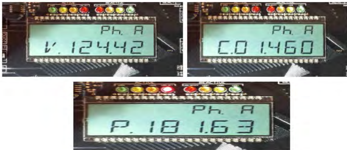
Figura 4. 13 Valores de voltaje, corriente y potencia en la fase A
