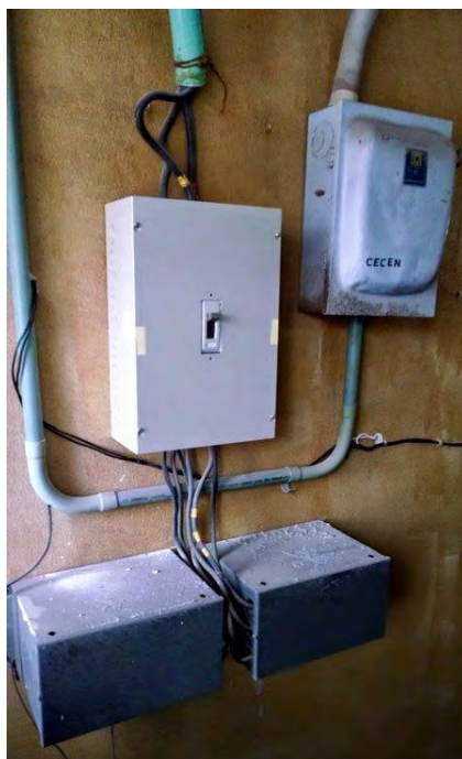
Figura 37 – Banco de capacitores ( Báez, 2014 ).
