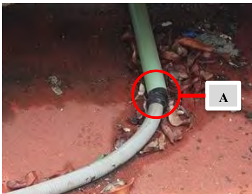
Figura 53 – (A) Falta de continuidad de la canalización, (B) Registros sin tapa (Góngora, 2014).
