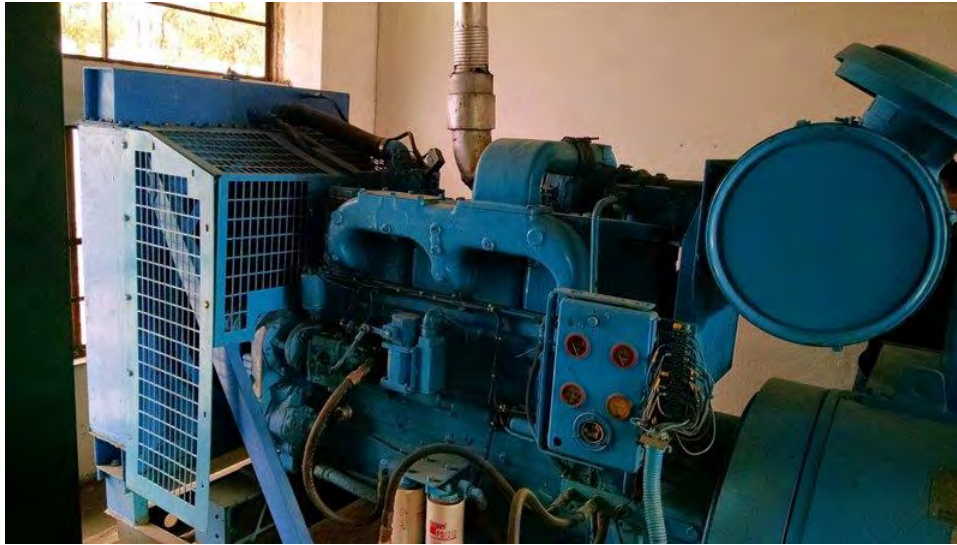
Figura 41 – Planta de emergencia del Hospital General (Báez, 2014).
