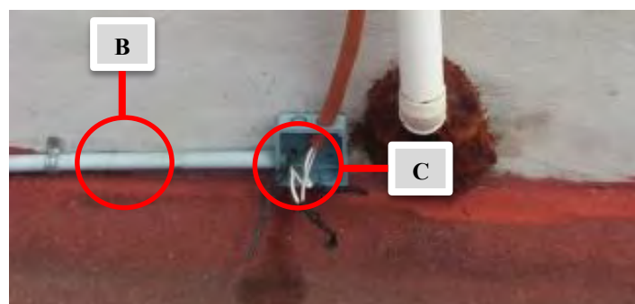
Figura 49 – (A) Conductores sin identificar, (B) Registro sin tapa, (C) Canalización incorrecta para intemperie (Báez, 2014).
