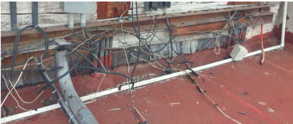
Figura 55 – Falta de canalización adecuada, conductores expuestos a la intemperie salitre (Góngora, 2014).
