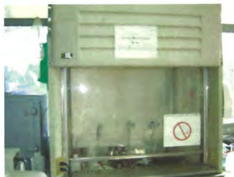
Figura 3.10.- Cámara de gases
