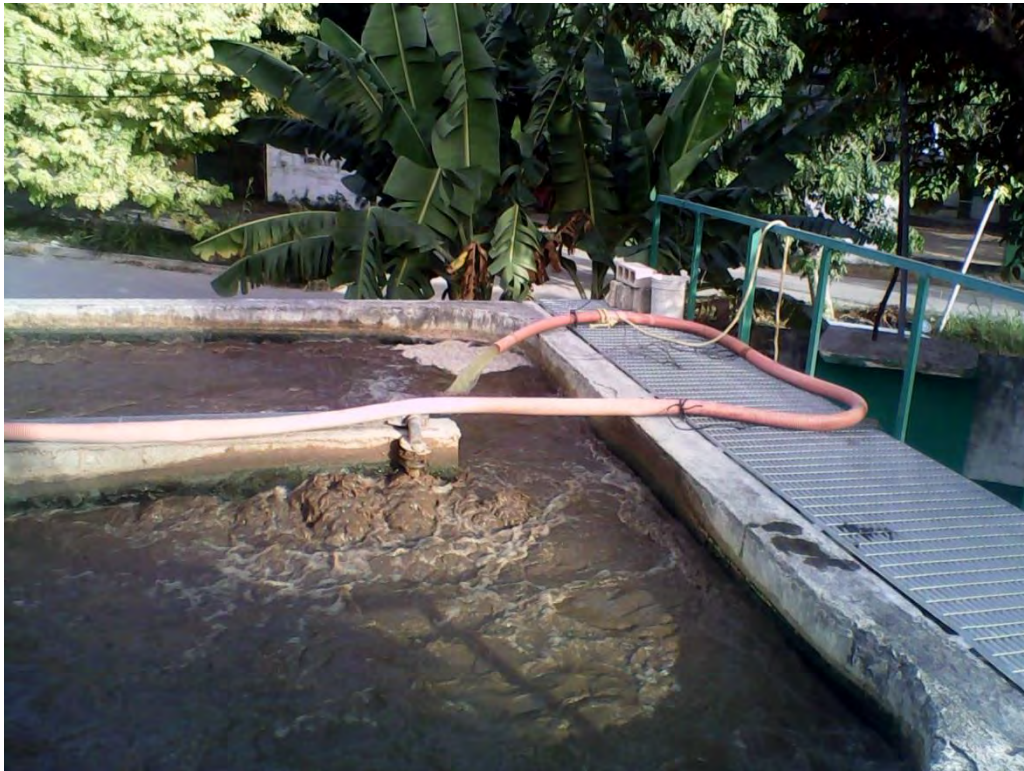
Figura 2.5. Bombeo de agua residual al reactor biológico.
