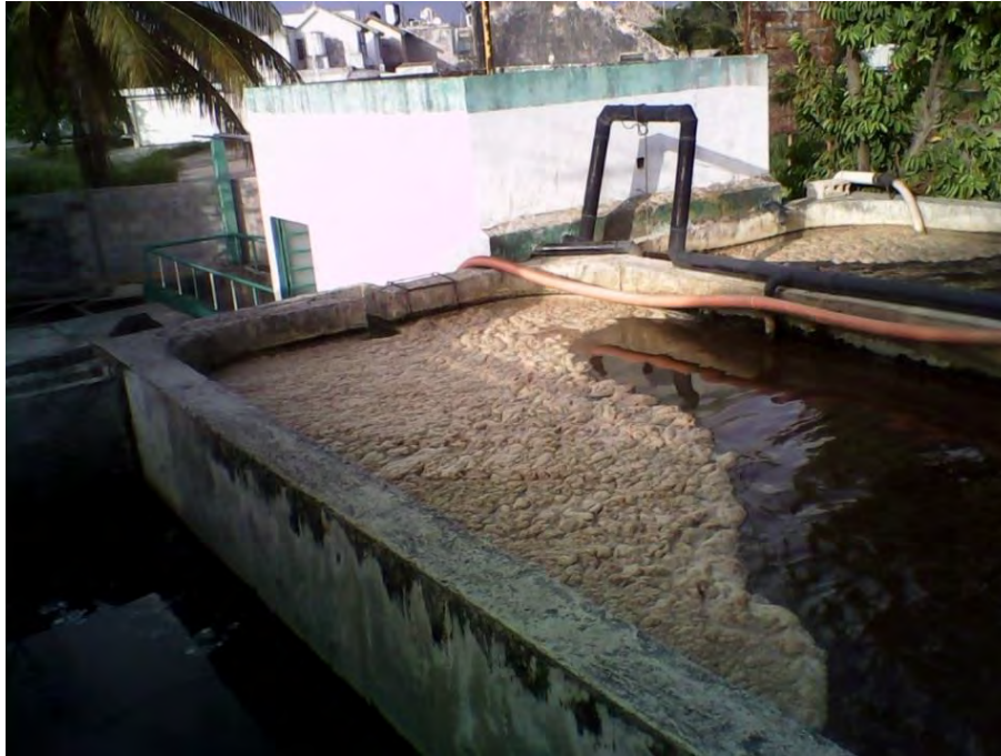
Figura 3.4. Formación de espuma en el reactor de lodos activados debido al crecimiento de Nocardia en el reactor.
