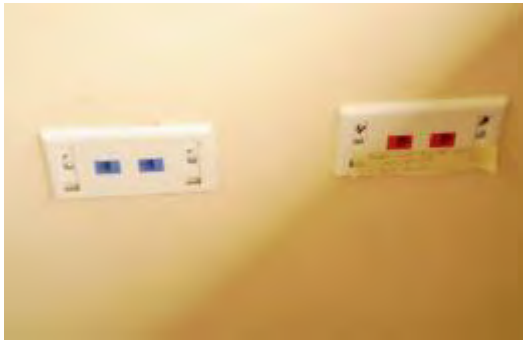
Figura 13. Salidas de Voz y datos en las áreas de trabajo, pared de tabla roca.
