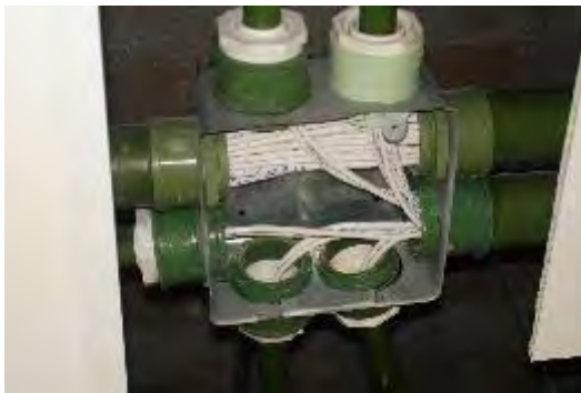
Figura 9. Vista de un registro abierto, distribución de los cables.
