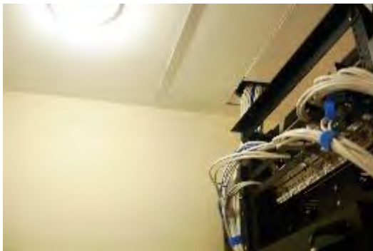
Figura 17. Vista trasera del rack de comunicaciones.
