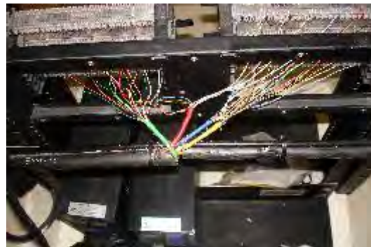
Figura 18. Cable de telefonía tradicional ponchadas en regletas 110 cat.6
