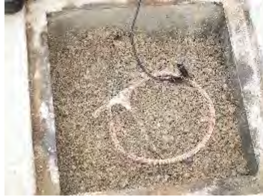
Figura 8. Circuito de tierra física de comunicaciones.
