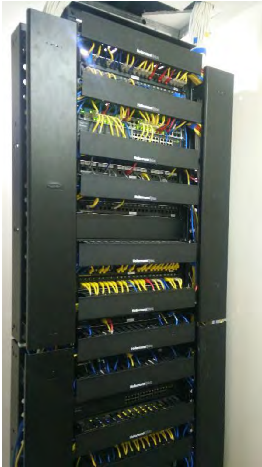
Figura 19. Vista frontal del Rack de Comunicaciones.
