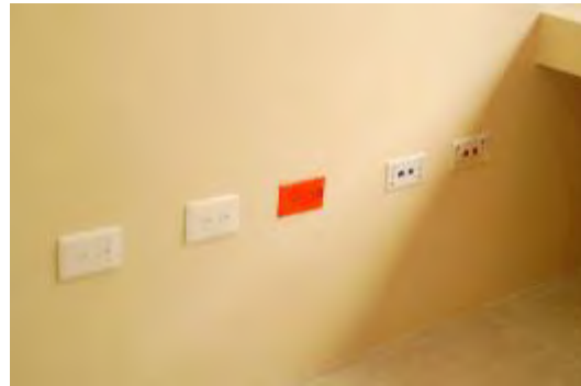
Figura 14. Salidas eléctricas en áreas de trabajo.
