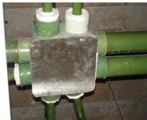
Figura 6. Ejemplo de distribución utilizando pvc y registro galvanizado.
