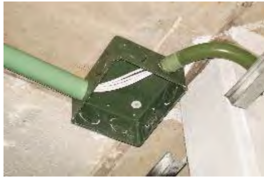
Figura 2. Registro de PVC instalado en un desvío de dirección de cables.
