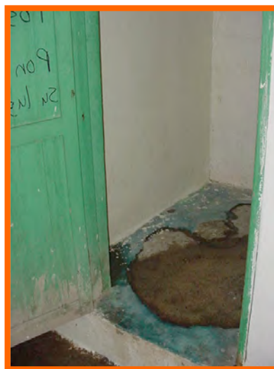
Figura 12. Cambiadores Fuente: Propia
