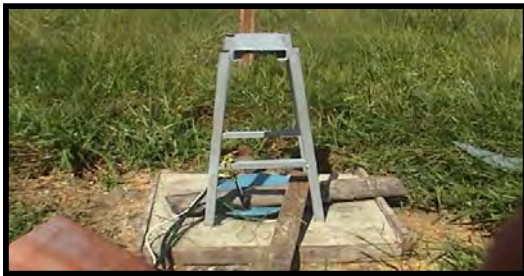
Figura 2.33 Pozo con bomba instalada instalados
