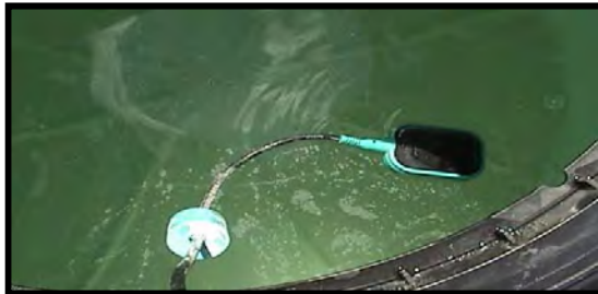
Figura 2.38 Electro nivel de los tanques
